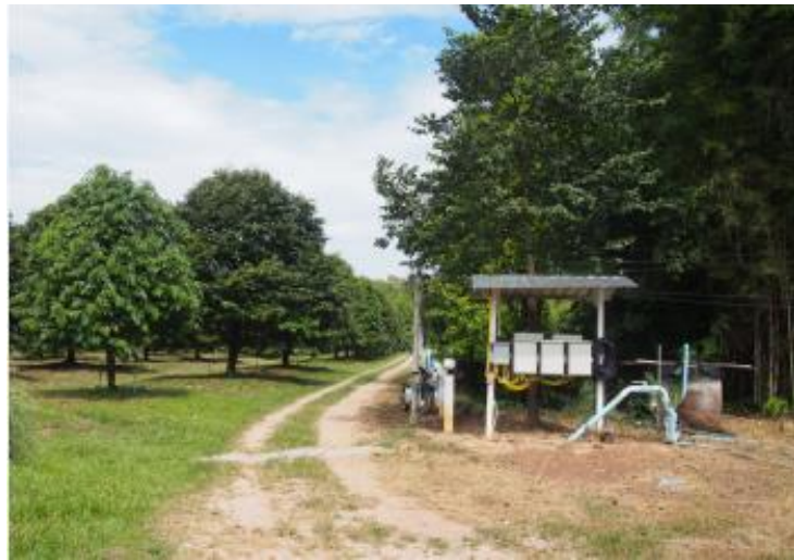
ภาพที่ 23 สถานีตรวจวัดอากาศแบบเคลื่อนที่ และ ระบบควบคุมและเซนเซอร์
